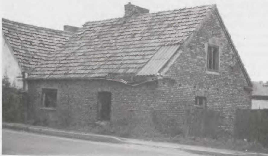
Fot. 3. Plewiska, gm. Komorniki k. Poznania. Budynek mieszkalny z przełomu XIX i XX wieku opuszczony i „skazany” na zniszczenie. Fot. W. Rączkowski
