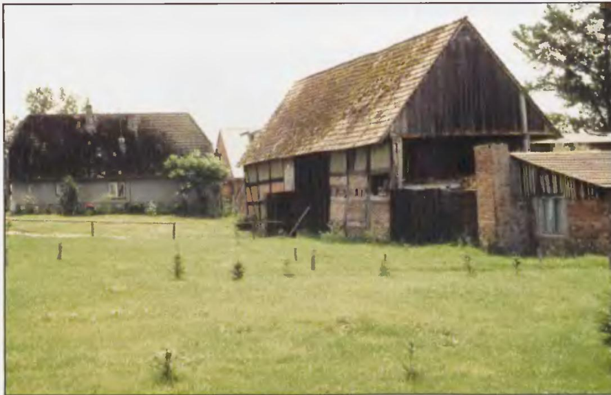
B. Sławsko, gm. Sławno. Przykład dewastacji zabytkowej architektury. Obiekt zabytkowy, który nie znajduje opieki ani właściciela, ani władz lokalnych ani służb konserwatorskich bardzo szybko popada w ruinę. Jego destrukcja 'rozwiązuje' problem wszystkim. A co z krajobrazem kulturowym, który powinniśmy ochronić i przekazać w dziedzictwie przyszłym pokoleniom? Fot. W. Rączkowski.
